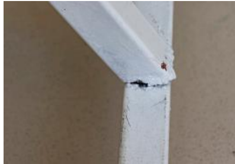
Şekil 16. Çatlak süreksizliği(Crack discontinuity)
