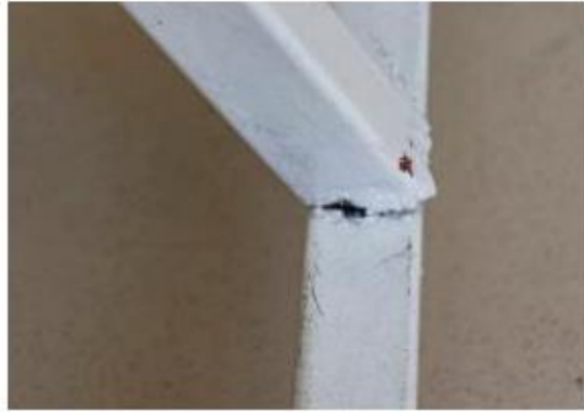
Şekil 16. Çatlak süreksizliği(Crack discontinuity)
