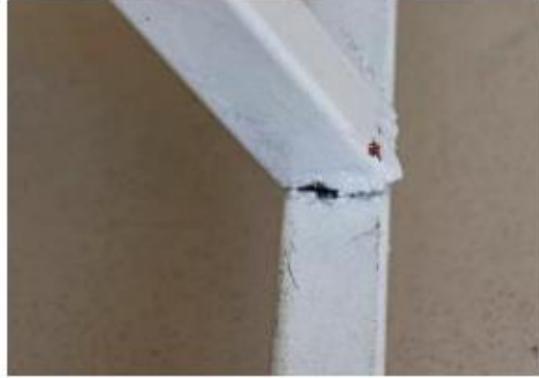
Şekil 16. Çatlak süreksizliği(Crack discontinuity)
